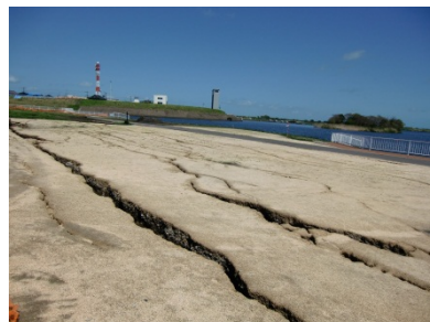
写真2 側方流動による多数の地割れ (香取市水の郷さわら)
