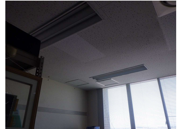
照明器具の故障
